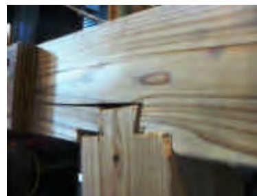
写真 4.7.6 上部材の割れ（最大変形時）
