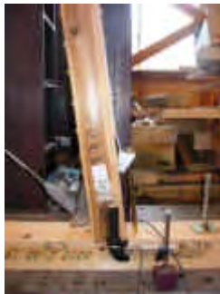
写真 4.5.3 右下接合部（最大変形時）
