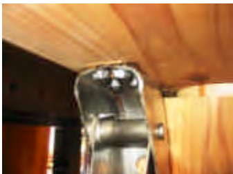
写真 4.7.5 右上接合部金物の変形 （最大変形時）
