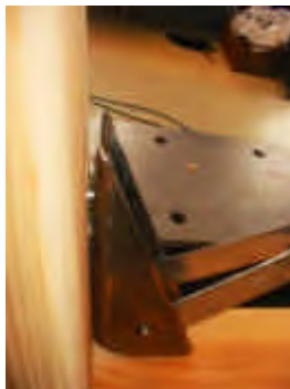
写真 4.3.5 金物ビスの引き抜け（最大変形時）
