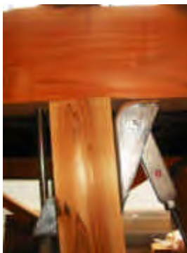
写真 4.2.5 左柱頭部（最大変形時）
