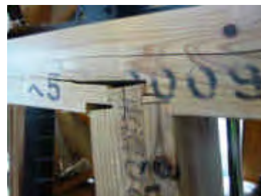
写真 4.2.6 上部材の割れ（最大変形時）
