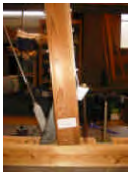
写真 4.2.3 右柱脚部（最大変形時）
