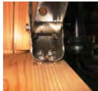
写真 4.5.6 左下接合部金物の変形（最大変形時）
